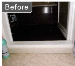
浴室入口の段差が12cmあるので、車いすでは入れなかった。
